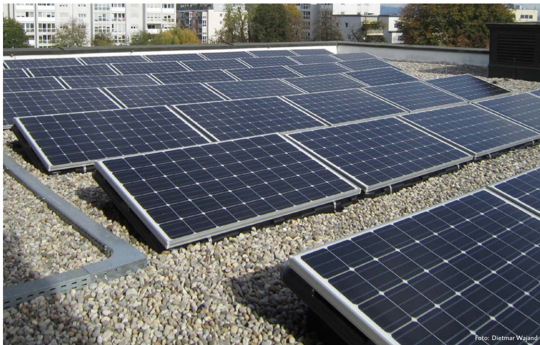
Unsere Photovoltaikanlage am Dach der Zentrale.
